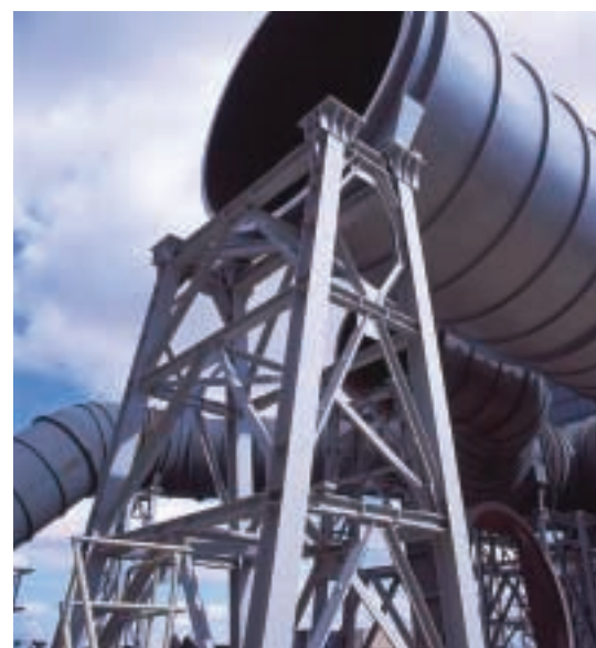
Nie istnieje potrzeba zabudowy izolacji zewnętrznej.
