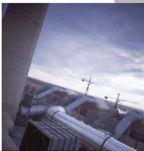
Kanały wlotowe i wylotowe IOS.
