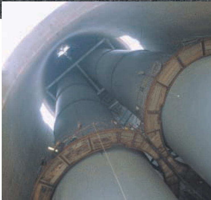
Dva ocelové válce, každý 176 m dlouhý.
