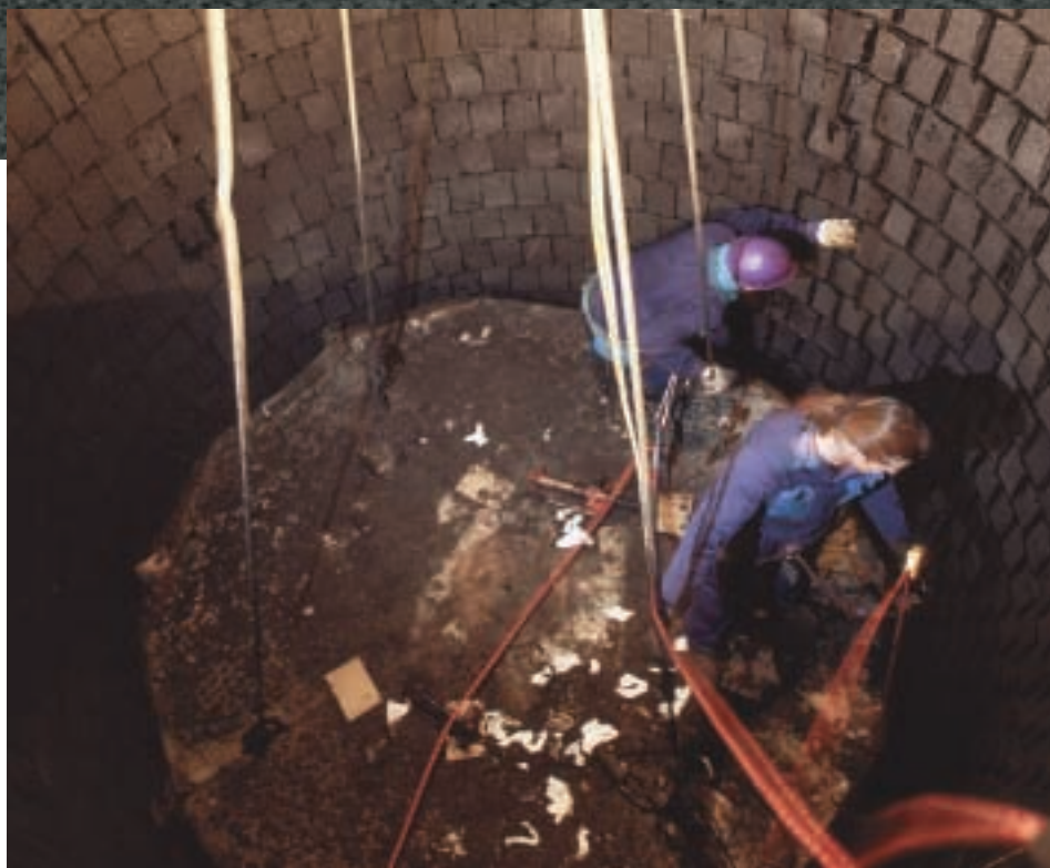
Trotz Zeitdruck und schwieriger Randbedingungen wurde eine Pennguard®-Auskleidung von hoher Qualität erzielt.
