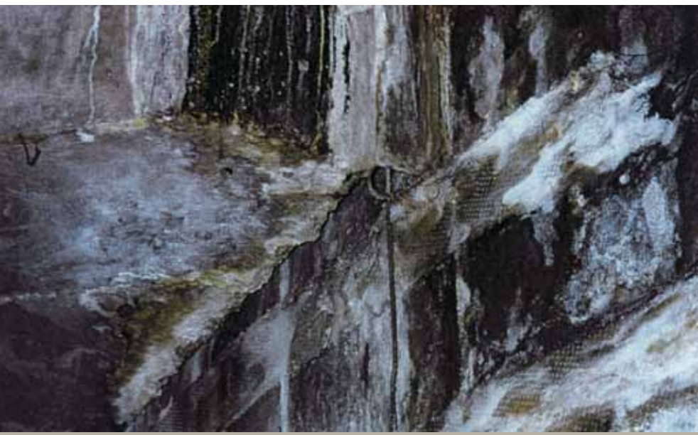
Rückstände von Sauerkondensat an der Außenseite des Futters.
