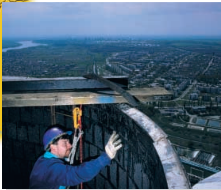
Vrcholová část betonové skořepiny komína je zvláště ohrožena "chladnějšími místy".
