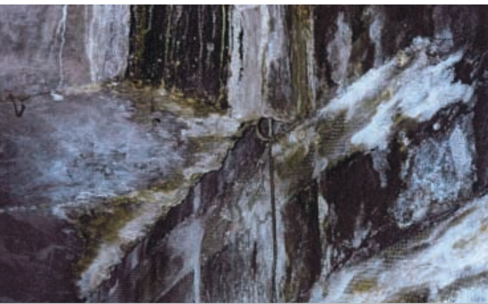
Kwaśny osad na zewnątrz wymurówki ceramicznej kanału spalinowego.
